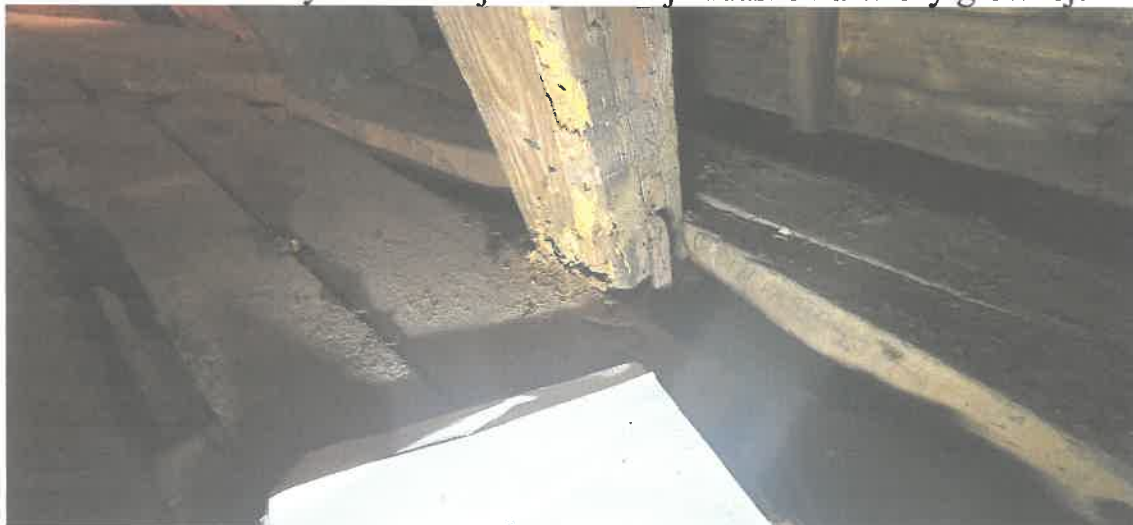
Zniszczone elementy konstrukcji drewnianej zadaszenia wieży głównej:
