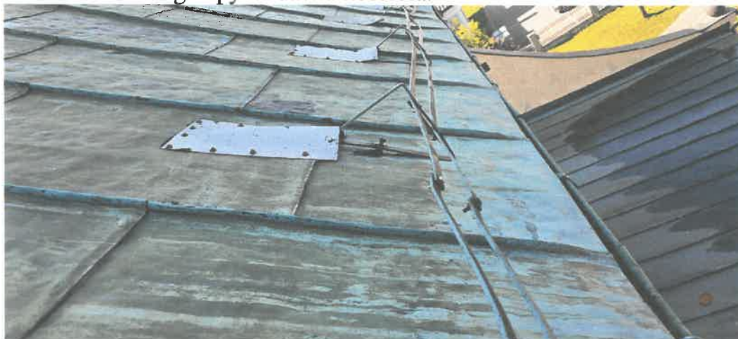
Uszkodzone śniegołapy na dachu kościoła:
