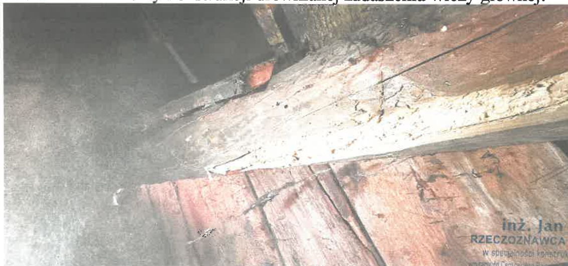
Zniszczone elementy konstrukcji drewnianej zadaszenia wieży głównej:
