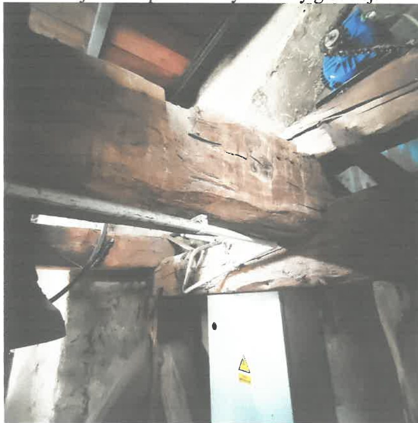
Konstrukcja nośna pod dzwony w wieży głównej:
