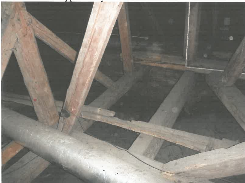
Widok uszkodzonej podwaliny:
