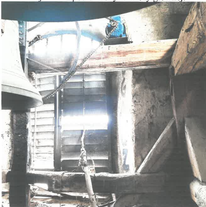
Konstrukcja nośna pod dzwony w wieży głównej:
