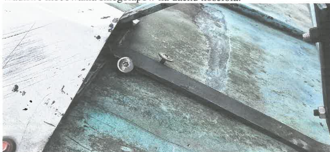
Wadliwe mocowania śniegołapów na dachu kościoła:
